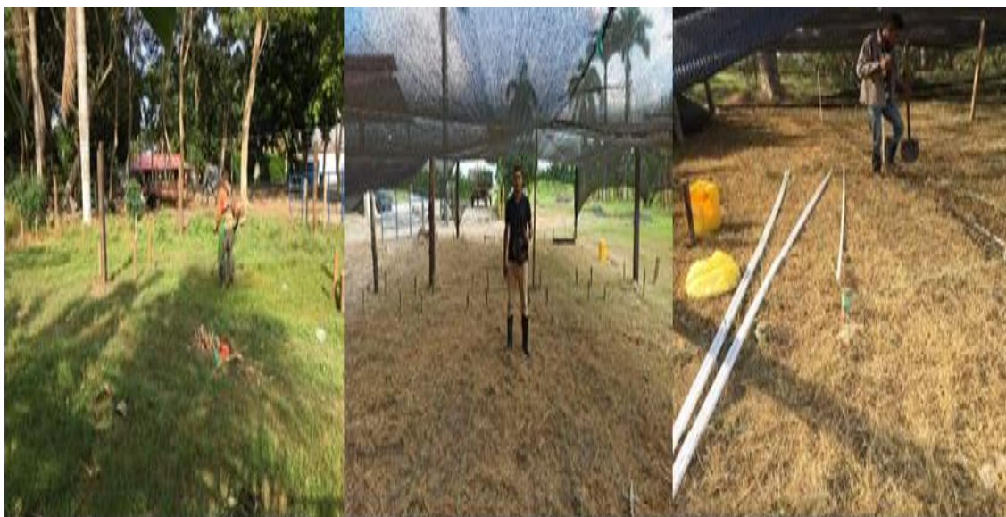
Figura 4: Adecuación del sitio, montaje del polisombra e instalación de sistema de riego.
